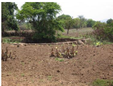
Ilustração 10: Exemplo de minibarragem em mau estado
